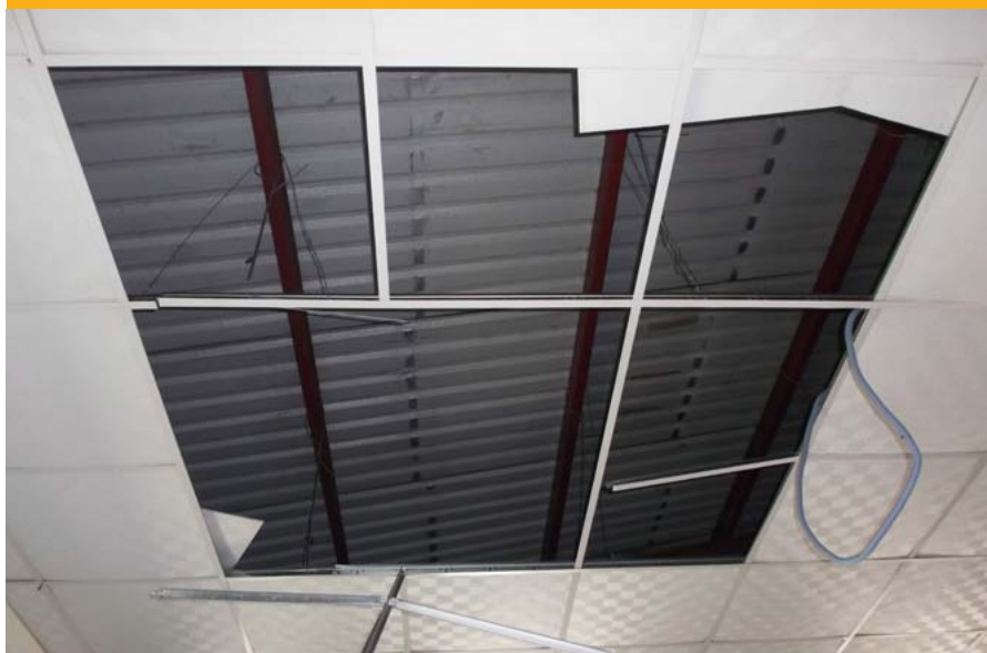
▲ Hiện trạng công trình trần sập trước khi Bốn Nguyễn khắc phục
