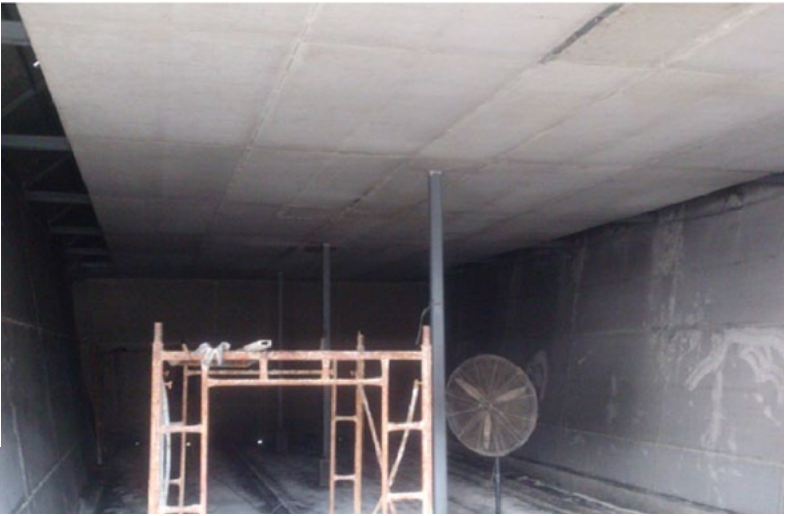
▼ Lắp sai tấm
