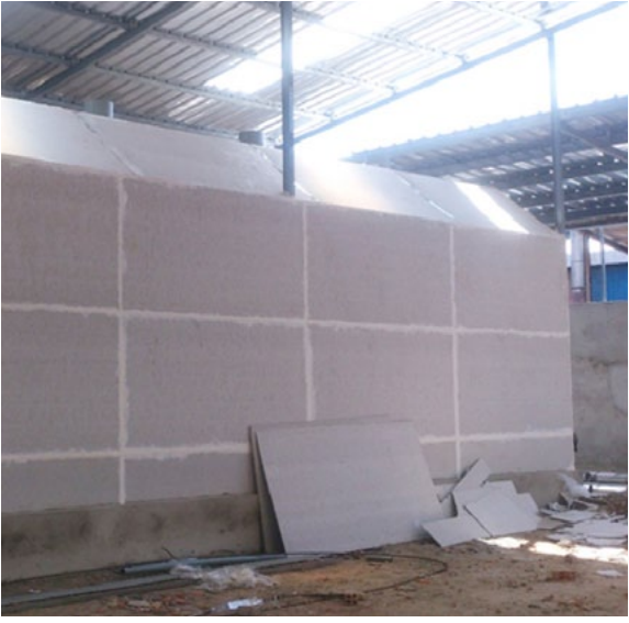
◀ Thi công sai từ khi chọn độ dày tấm
